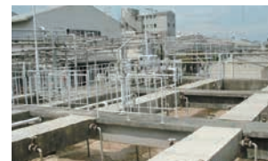
活性汚泥排水処理施設(徳島工場北島事業所)
