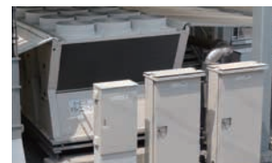
冷却水の循環再利用設備(丸亀工場)
