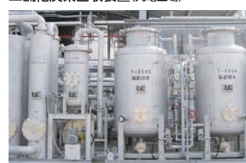
二硫化炭素回収装置(丸亀工場)
