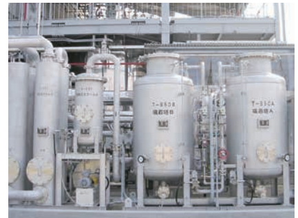
二硫化炭素回収装置(丸亀工場)
