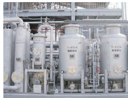
二硫化炭素回収装置(丸亀工場)
