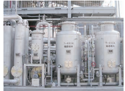
二硫化炭素回収装置(丸亀工場)
