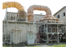
排ガス洗浄処理施設(徳島工場北島事業所)
