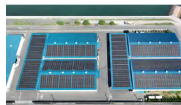
丸亀工場北エリア：太陽光パネル
