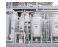
二硫化炭素回収装置 （丸亀工場） 不溶性硫黄製造工程で使用する二硫化炭素を回収する装置です。
