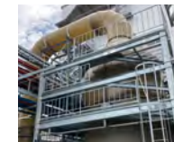
排ガス洗浄処理施設 （徳島工場北島事業所） 塩素化イソシアヌル酸製造工程で発生する塩素を集合させて洗浄処理する設備です。
