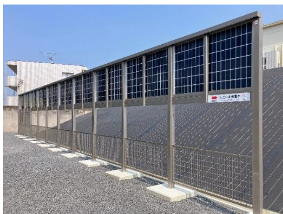
▶実際に設置された垂直設置型太陽光発電「ソリスパネル」
